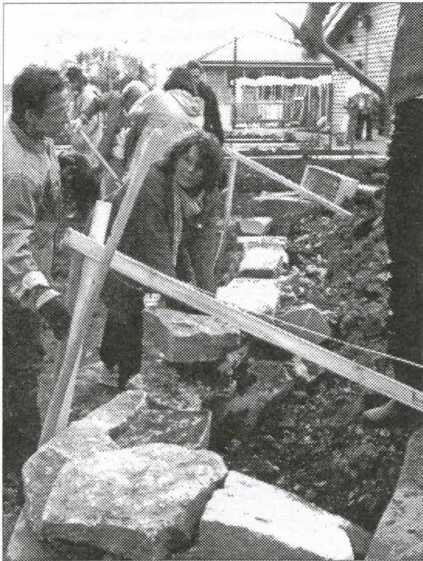
Aufschichtung von Natursteinen zu einer Stützmauer. Hinter den Steinen muss als „Dränage“ Lockergestein eingebracht werden. Wärmeliebende Tiere wie die Zauneidechse finden hier Unterschlupf.
